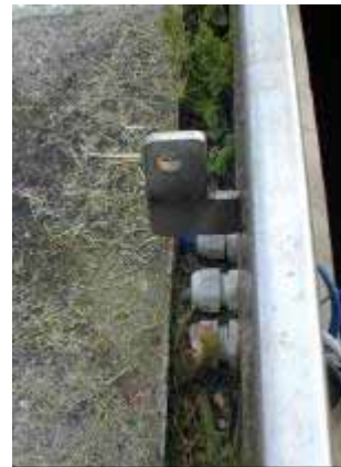
Kabelgennemføringer i dækselkarm er uheldig placeret nær ved terræn, hvilket kan føre til vandindtrængning.
